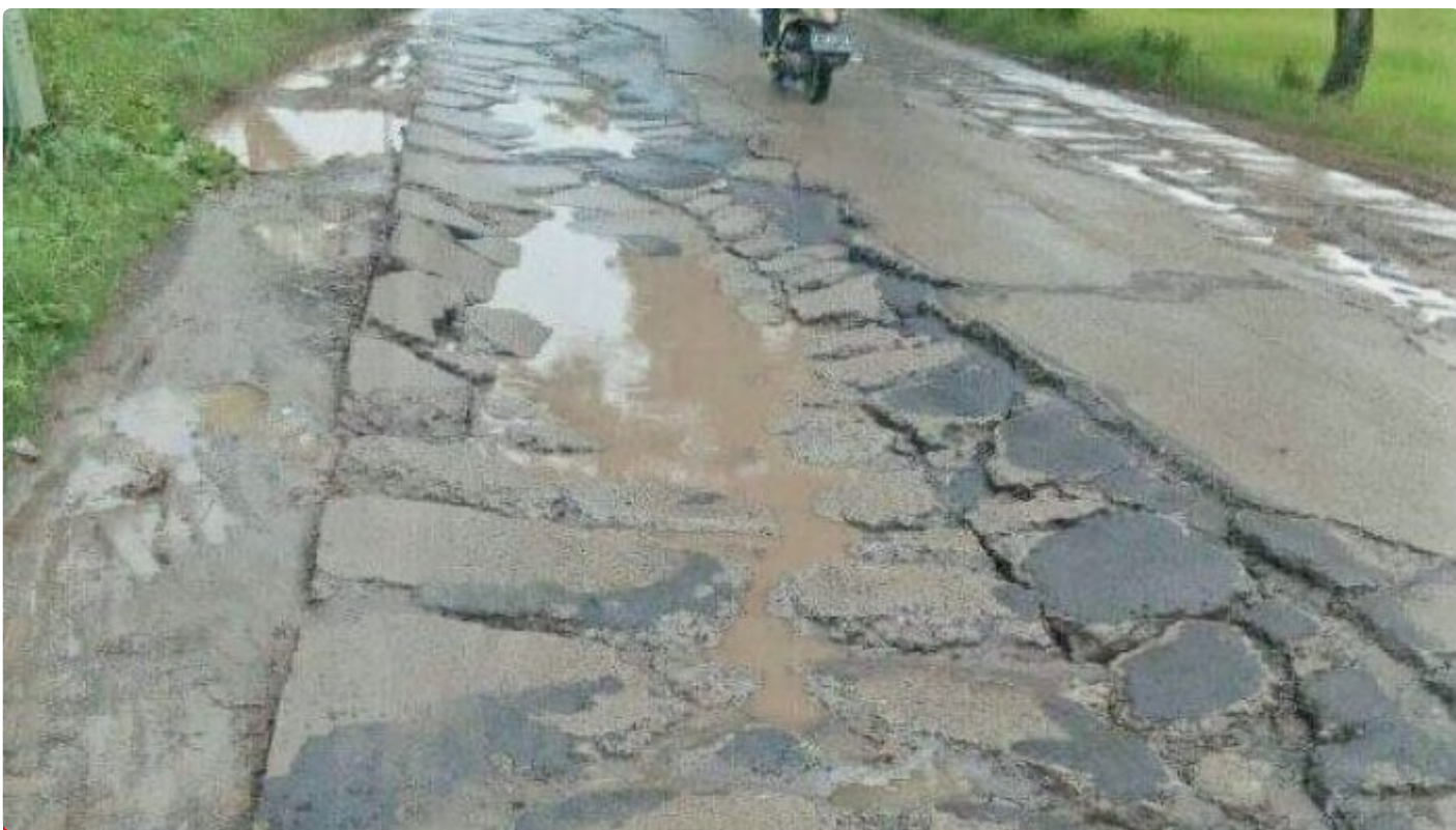
Jalan Beyeh-Simpang yang sudah sangat rusak parah
